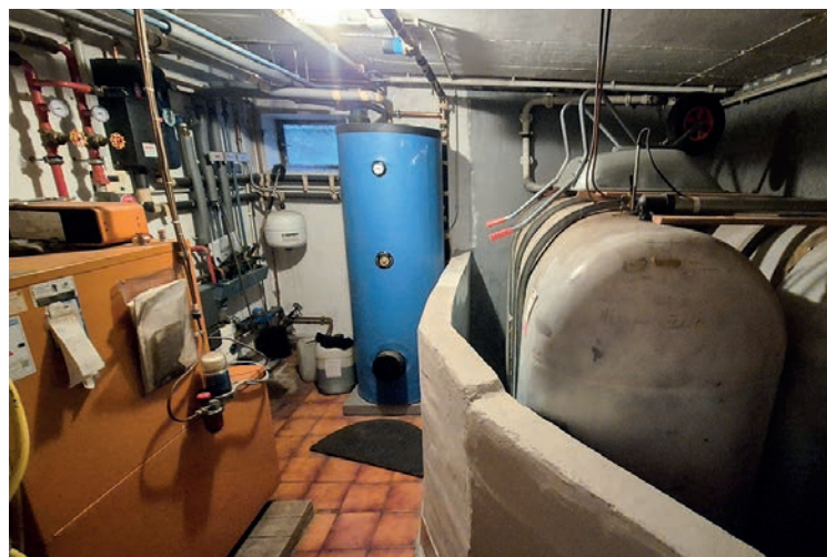
Heizungsraum mit Öl-Tanks
